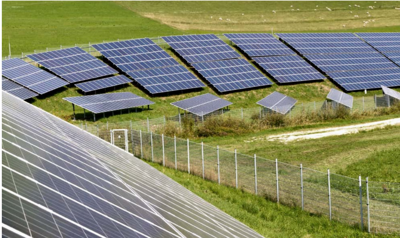
Abbildung 2: Photovoltaikanlage zur Nutzung der Sonnenenergie
